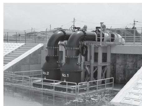
雨水調整池排水用 大型水中ポンプ(北九州市)
